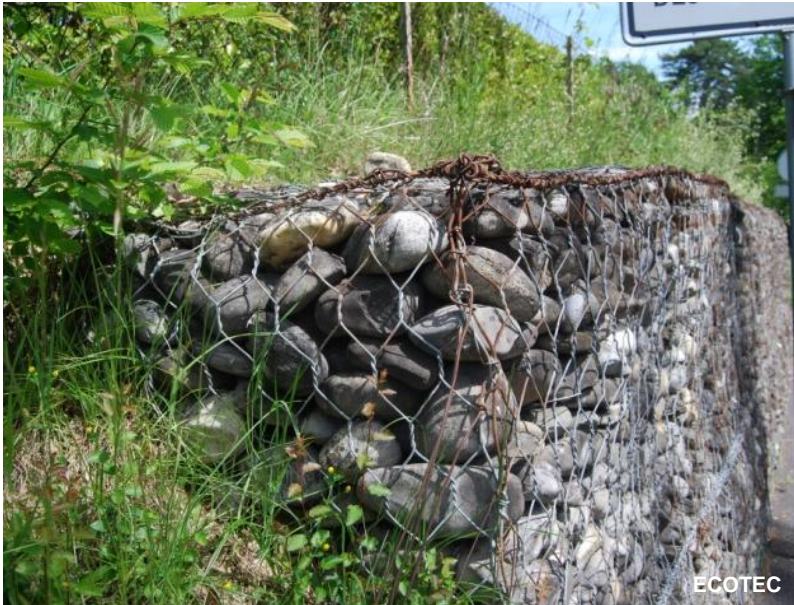
Gabion de soutènement en galets de rivière locaux (L'Arve)
